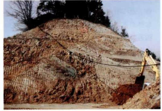
図 II-6-8 道路の切り通しに現れた断層 (Spot 2)
